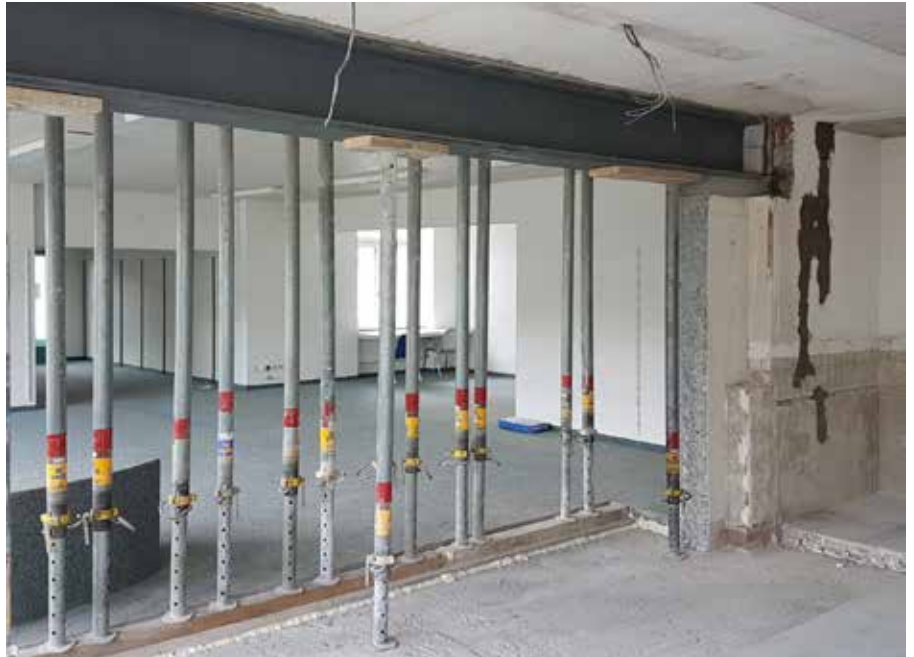
Der grosse Stahlträger übernimmt die statischen Kräfte.
